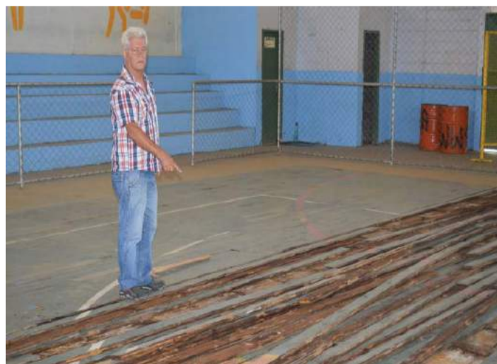
Jairo Amaral supervisionou o início da retirada do piso de madeira do ginásio
